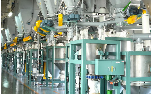
原料計量 Dosing equipment
