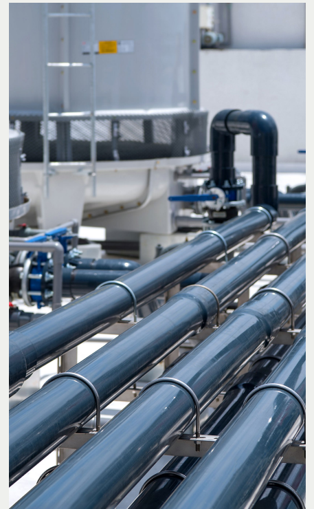
冷凍空調工程 Air Conditioning project
